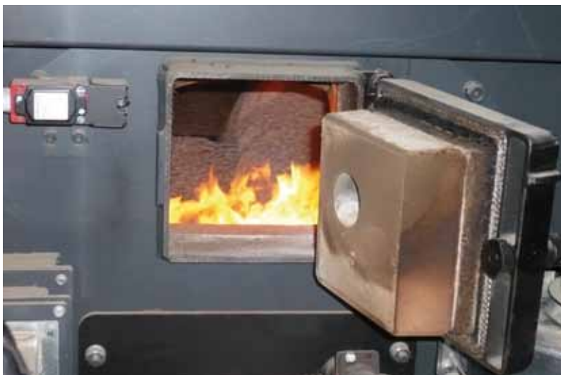
Cambrà de combustió d'una caldera d'estella. Foto: Agència Local de l'Energia d'Osona.
